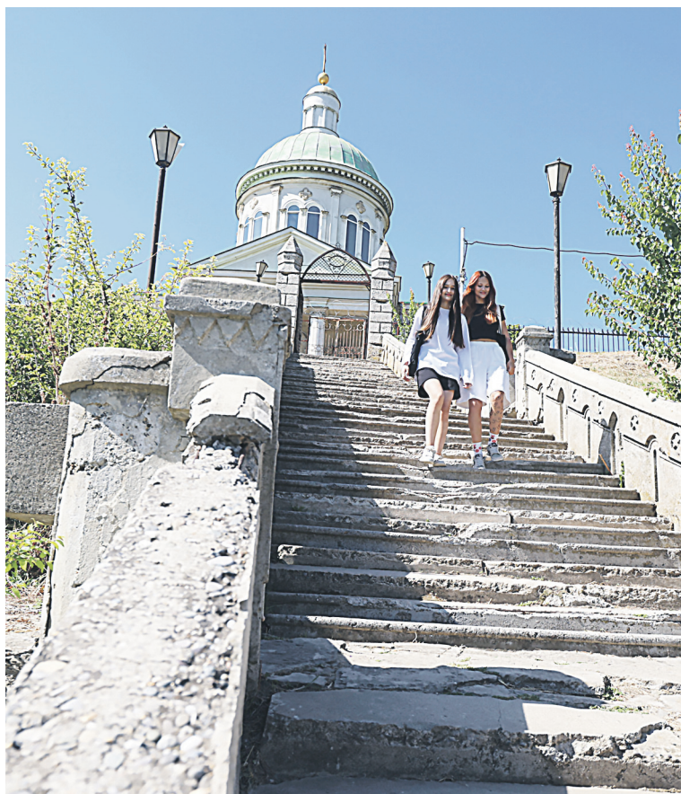
Ведущая к церкви лестница в ужасном состоянии: кажется, что по ней проехал гусеничный трактор.
